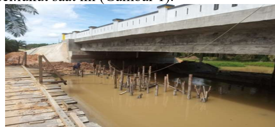
Gambar 1 Kondisi Jembatan Sei. Lukut di Kecamatan Rumbai
