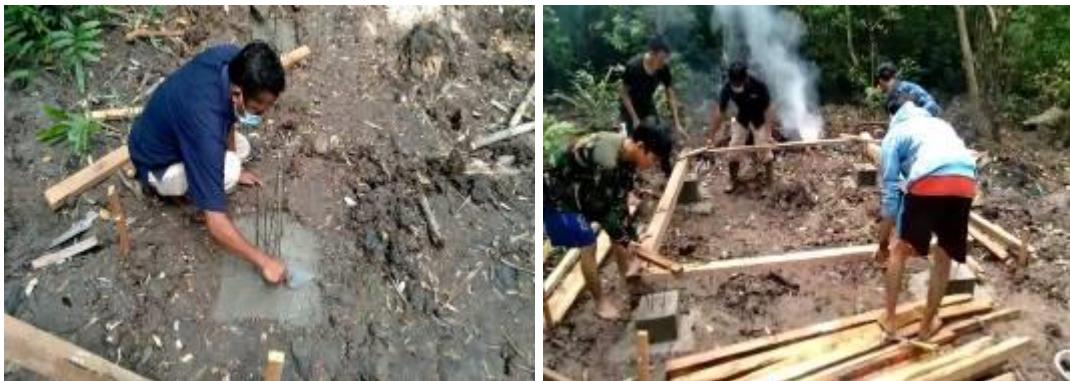
Gambar 5. Pembuatan pondasi tapak dan Pemasangan balok lantai utama (Juli Ardita Pribadi R, Lizar, Muhammad Idham & Ahmad Yani, 2021)
