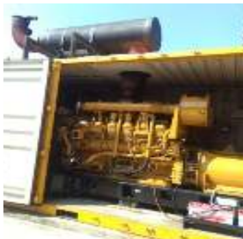
Gambar 2 Mesin Caterpillar 3512B (Sumber: Dokumentasi Penulis)
